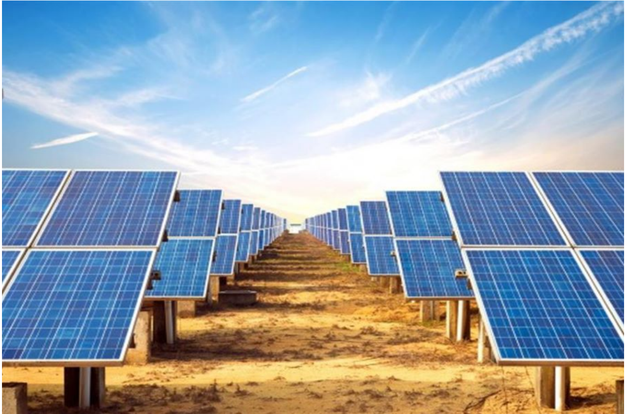
Рис 1.1 Загальний вигляд сонячної електростанції
