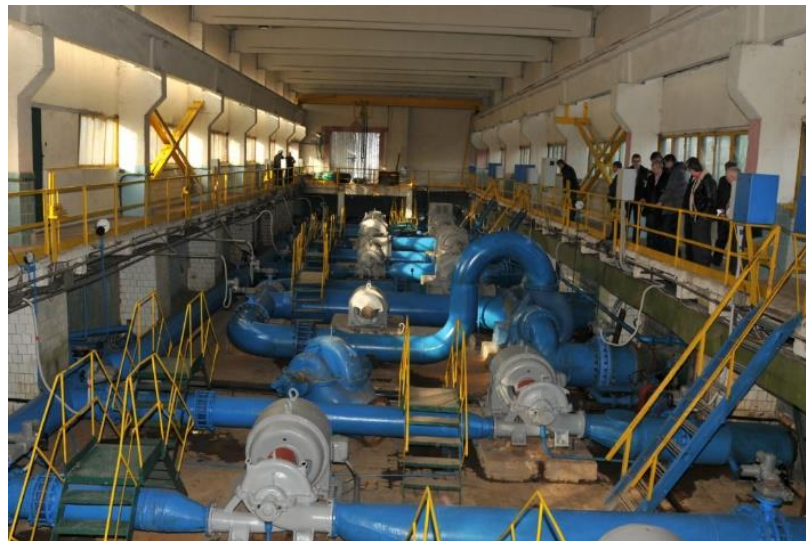
Рис. 6.2 Загальний вигляд насосної станції
