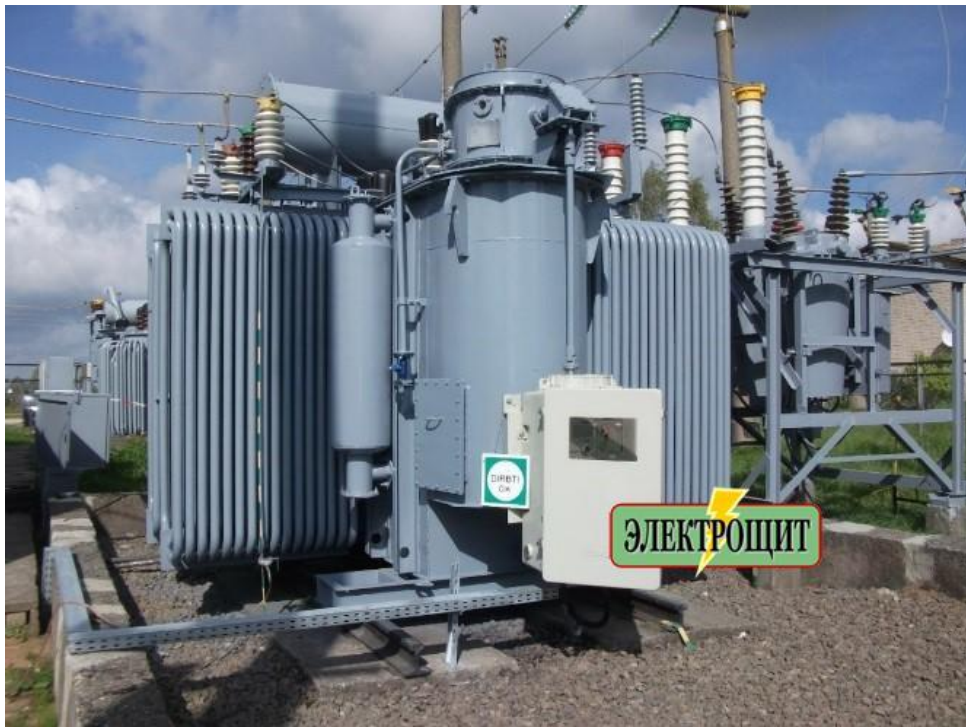
Рис 2.4. Силовий трансформатор типу “ТМН-10000/35”.
