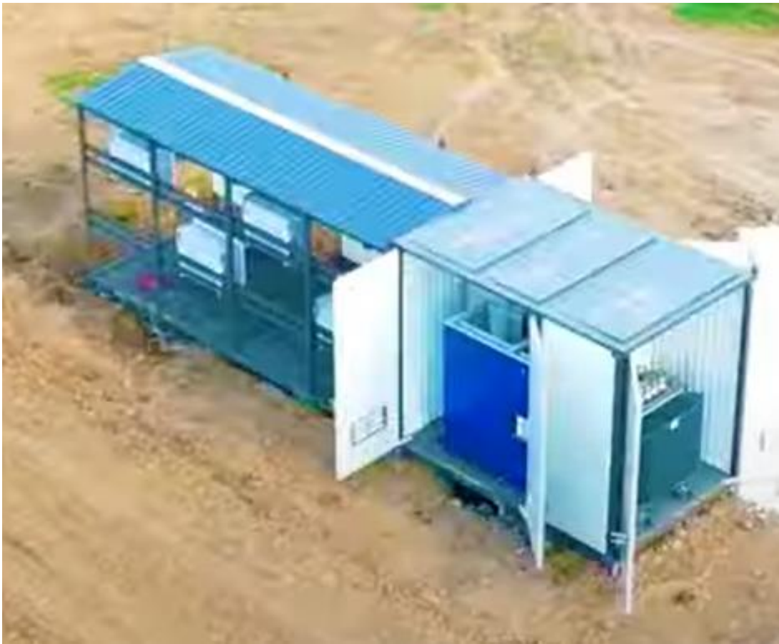
Рисунок 2.13 - Приклад окремої інверторної підстанції.
