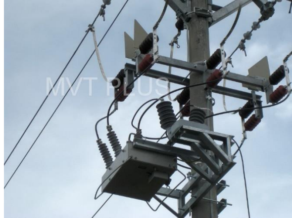
Рис.2.5.1. Реклоузер компанії MVT PLUS
