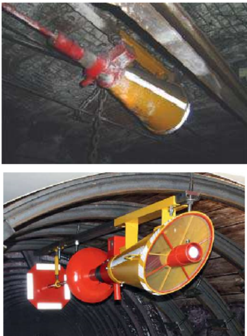
Рисунок 3.6 — Система АСВП-ЛВ, змонтована під покрівлею гірничої виробки
