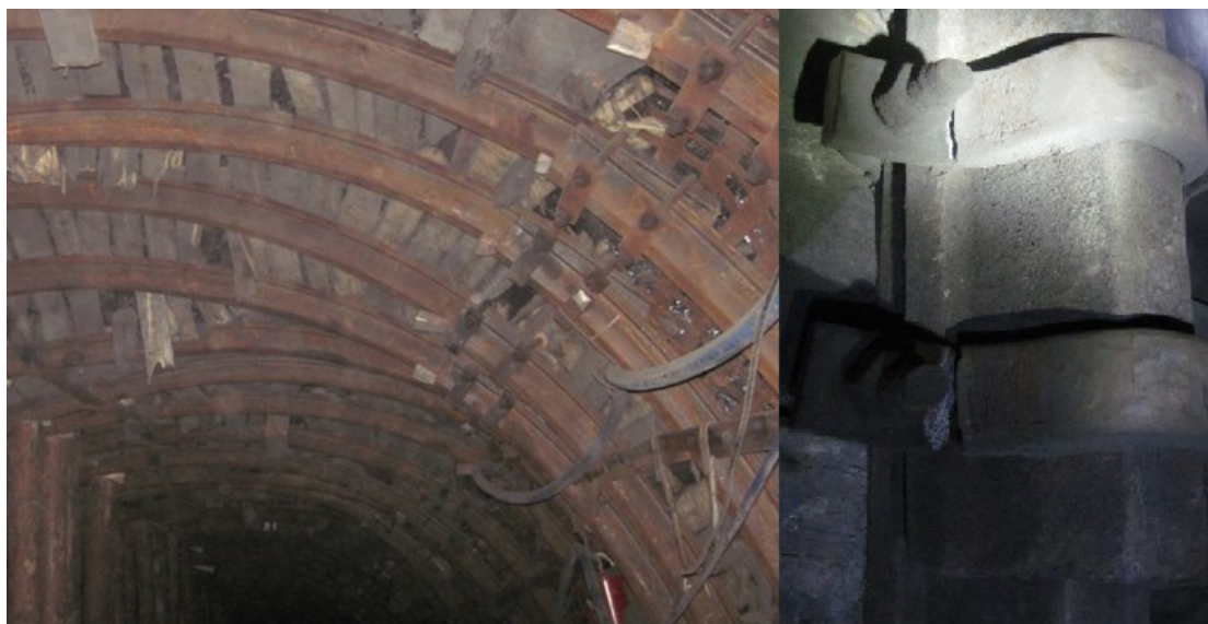
Рис. 6. Состояние элементов крепи 18-го южного конвейерного штрека пл. II в районе ПК5
